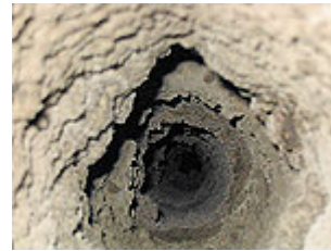
Erhöhte Brand- und Krankheitsgefahr: Entlüftungsschächte werden häufig nicht gewartet Foto: ZDS/Graf
